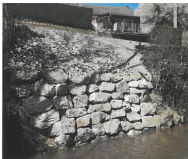
Éboulement talus route de Chaunac à Naves.
